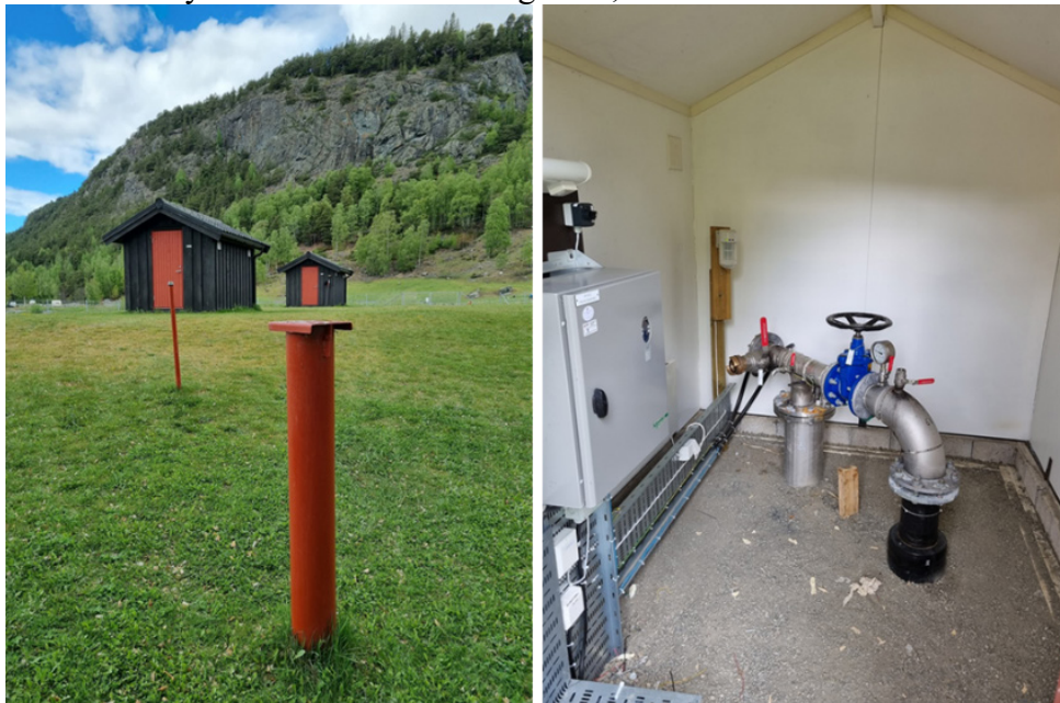
Figur 9-2 To av brønnhusene på Kokkehaugen (venstre) og installasjonene inne i brønnhusene (høyre) (Foto Vågå kommune, mai, 2022)
